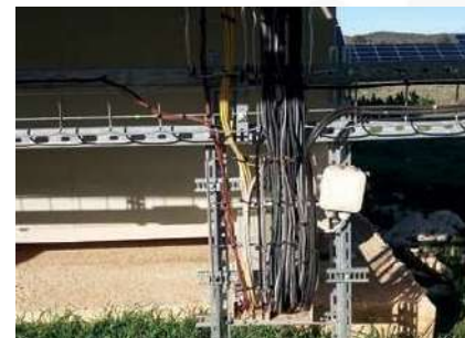
Câblages laissés apparents (©Idele)
